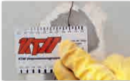
Umlaufende senkrechte Risse größer 0,3 mm Circumferential vertical cracks larger than 0.3 mm
