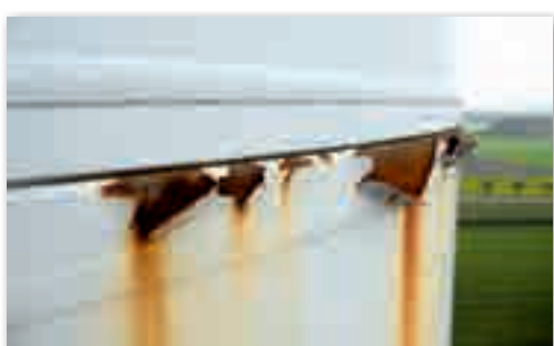
Korrodierte Stoßfugen, gegebenenfalls auch mit Flanschklaffung Corroded butt joints, possibly also with flange gap
