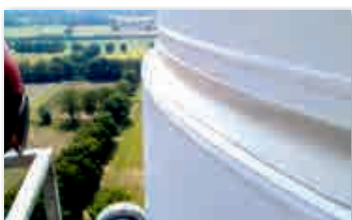
Elastische Polysulfid-Fugenbänder im Übergang zwischen Adapterelement und erstem Stahlturmsegment Elastic polysulphide joint tapes at the transition between adapter element and first steel-tower segment
